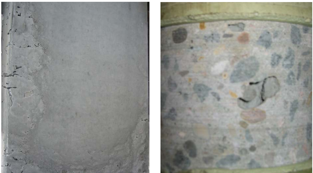
Bild 4.19 (links): Entmischungen am Stützenfuß bei Stütze 2a
